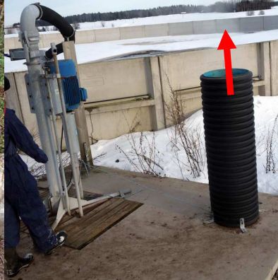
Gödselgasventilation med fläkt som fungerar ibland, ibland inte.
