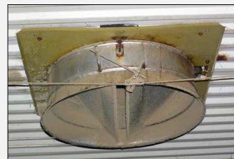
Inlopp med kant som inte är tillräckligt strömlinjeformad
