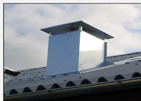
Platsbyggd takhuv som ej är strömlinjeformad och med för liten öppning i förhållande till luftflödet
