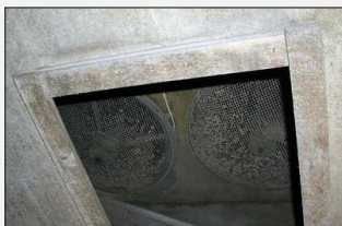
Igensatt skyddsgaller. Fläkt i trång platsbyggd kanal
