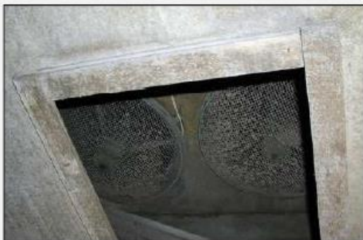
Igensatt skyddsgaller. Fläkt i trång platsbyggd kanal
