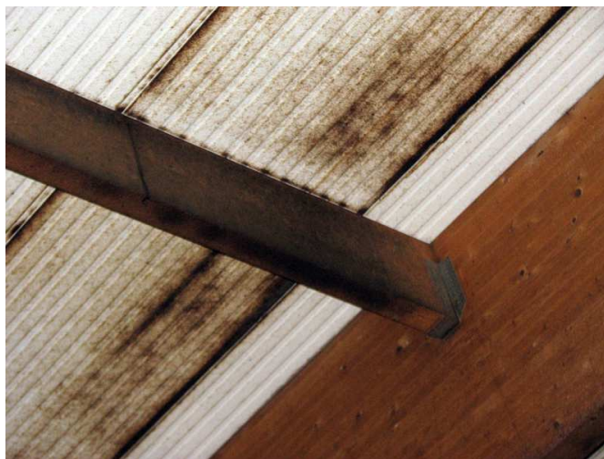
Fuktskador efter 2 år
