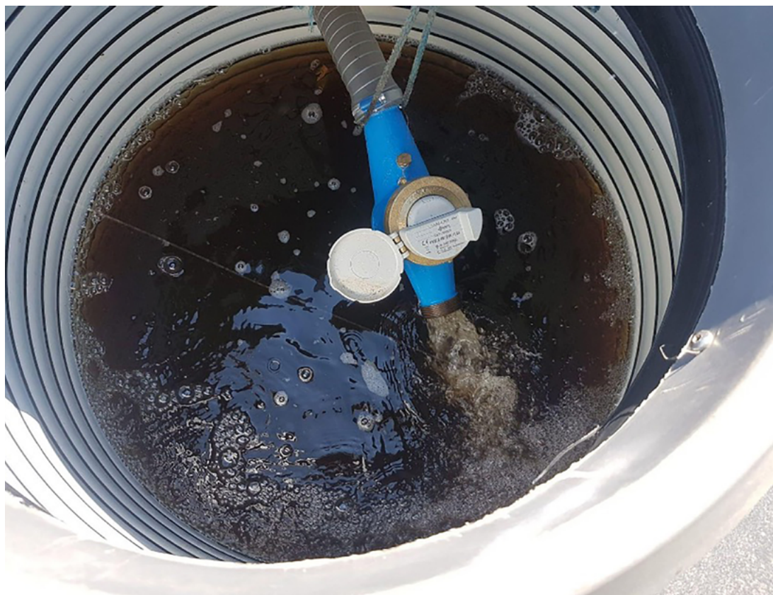
Figur 6.3. Grundvattennivån regleras med hjälp av en reglerbrunn. Vid underbevattning kan man pumpa in vatten utifrån till dikessystemet via reglerbrunnen. (Bild: Markus Sikkilä.)
