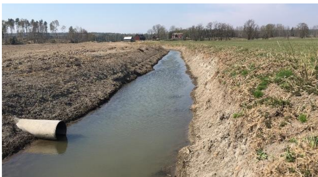
Dike med en bra avfasning till vänster och en skarp slänt med ras till höger. Gräsinsådd saknas ännu. Foto: Kristian Jochnick.
