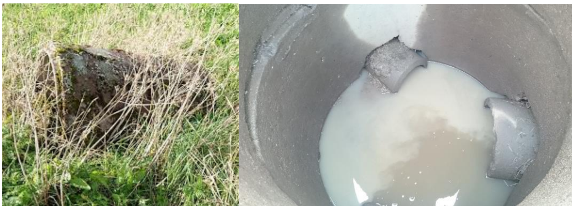
1. Brunn i behov av underhåll 2. Brunn med trasig anslutning till in- och utlopp, vilket skapar sedimentation i systemet. Foto: Sofia Kämpe och Tobias Neselius
