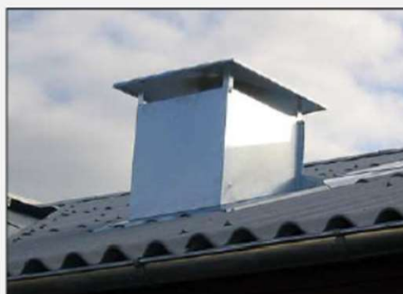
Platsbyggd takhuv som ej är strömlinjeformad och med för liten öppning i förhållande till luftflödet
