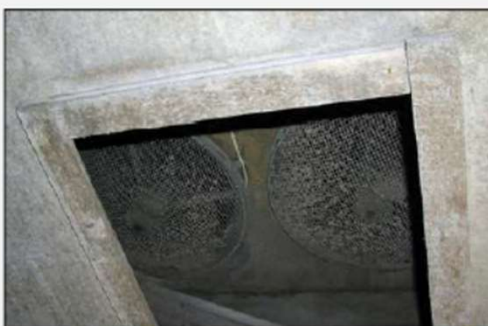
Igensatt skyddsgaller. Fläkt i trång platsbyggd kanal
