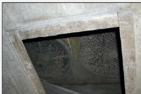
Igensatt skyddsgaller. Fläkt i trång platsbyggd kanal
