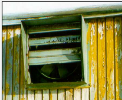
Trasigt och faststatat jalusispjäll
